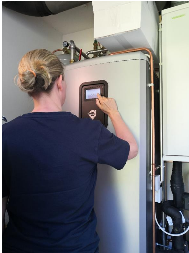
Inomhusenhet för värmepump. © NTM-centralen i Södra Österbotten.
