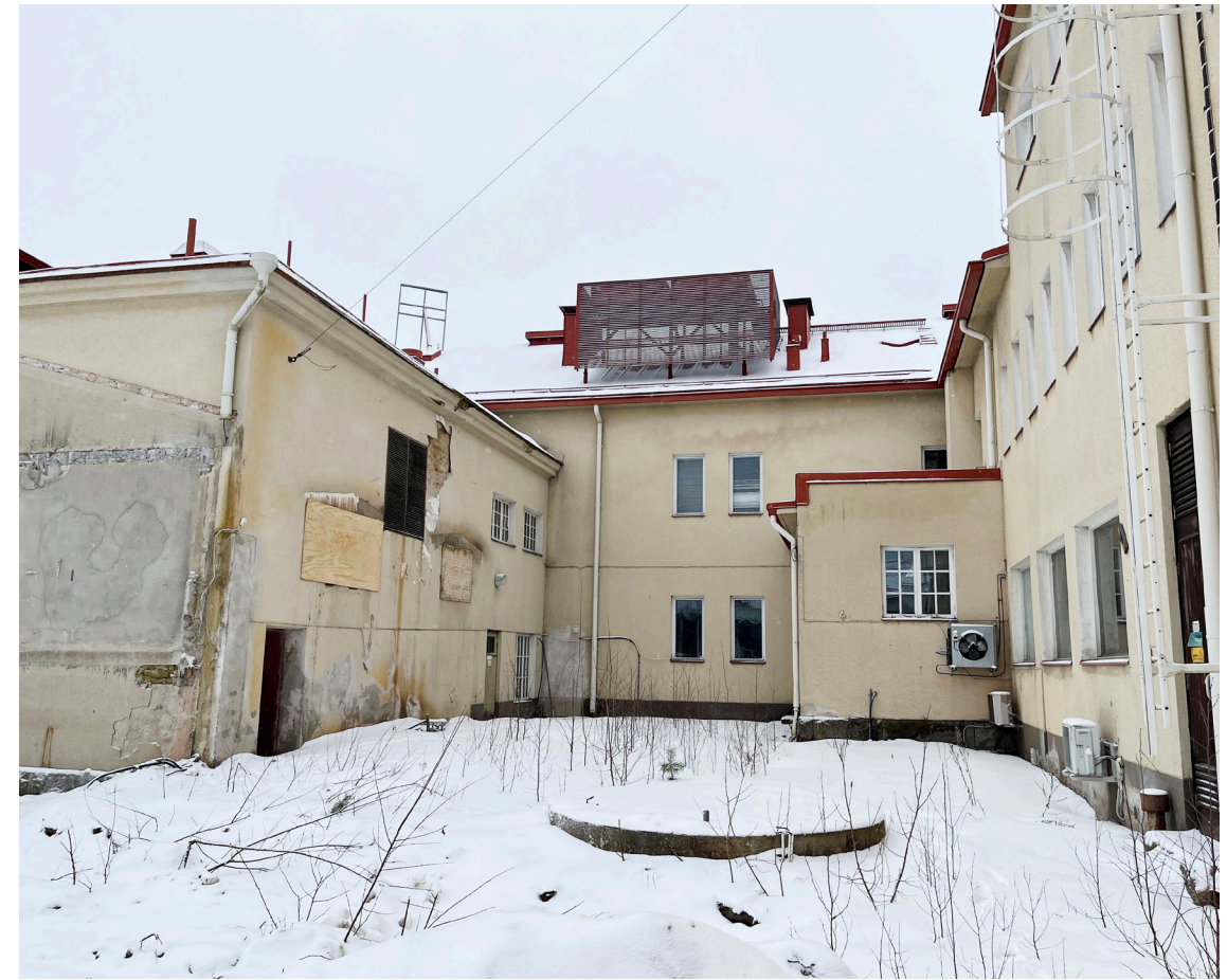
Sisäpihan puolella julkisivussa on enemmän vauriokohtia etenkin kylmänä olleen kattilahuoneen kohdalla (kuvassa vasemmalla). Rästystäällä vaikuttaa olleen vuotokohta, josta vesi on päässyt seinärakenteeseen. Kattilahuoneen päädyssä sijainneen osan purkutöissä oletettavasti katkaistu vesiputki on jatkettava maahan asti, jotta sadevesi ei pääse vaurioittamaan julkisivua enempää.
