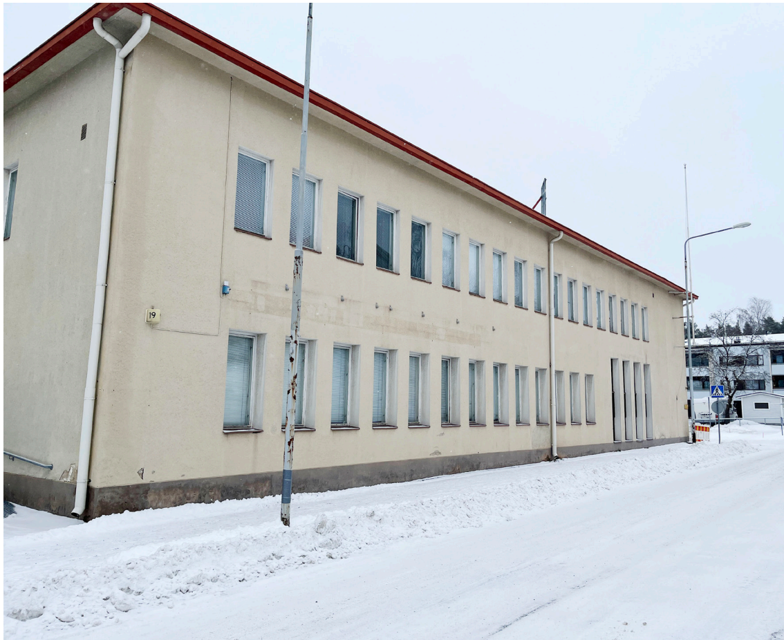
Vuorikadun ja Joos. Sajaniemenkadun puoleiset julkisivut ovat kohtalaisen hyvässä kunnossa. Ikkunat kaipaavat huoltokorjausta (mm. vesipeltien kaadot).
