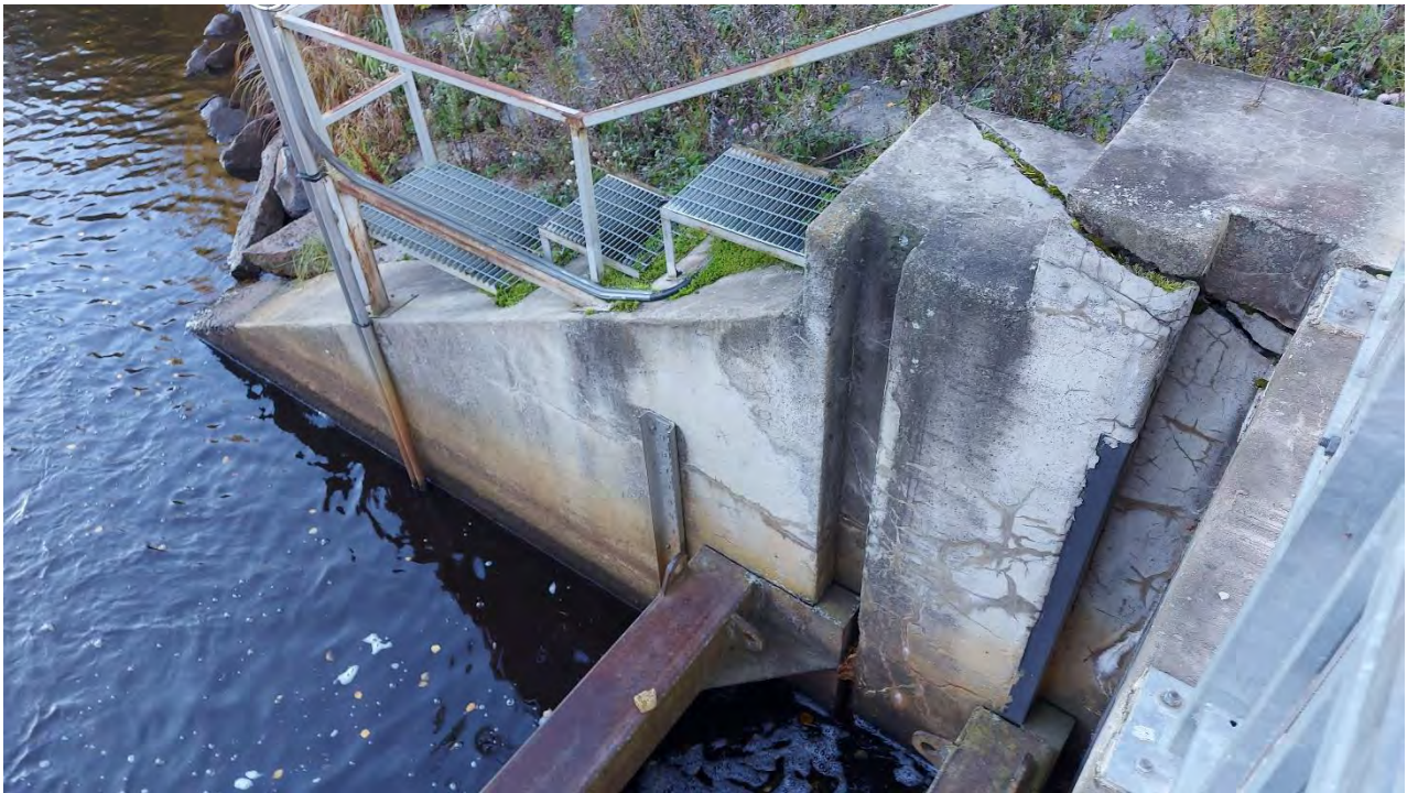
Kuva 2-2: Piehingin padon betonirungon vaurioita
