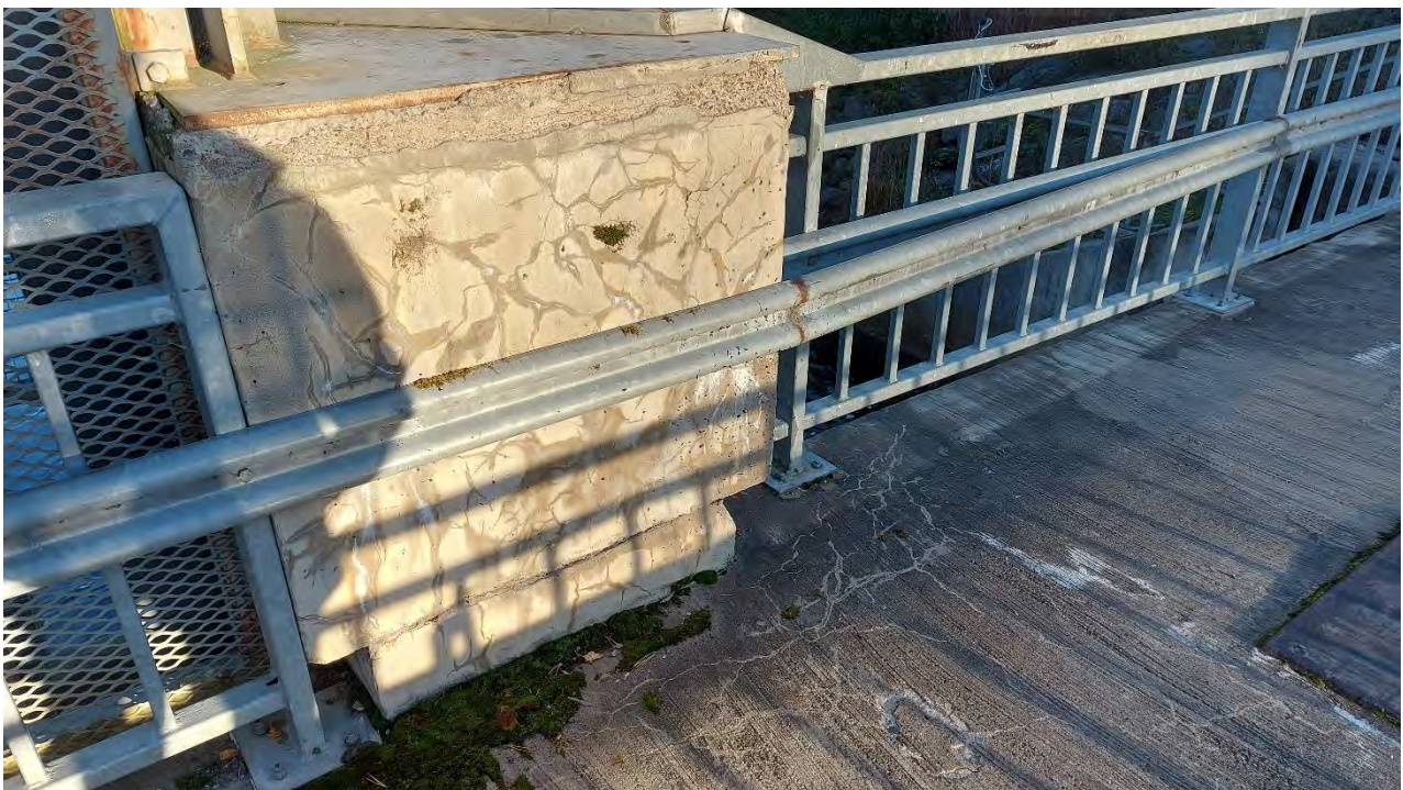
Kuva 2-3: Piehingin padon betonirungon vaurioita
