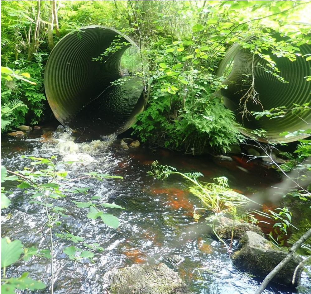
Kuva 14. Vaellusesteellinen tierumpu (nro 21) Pilpaseläntien alla.
