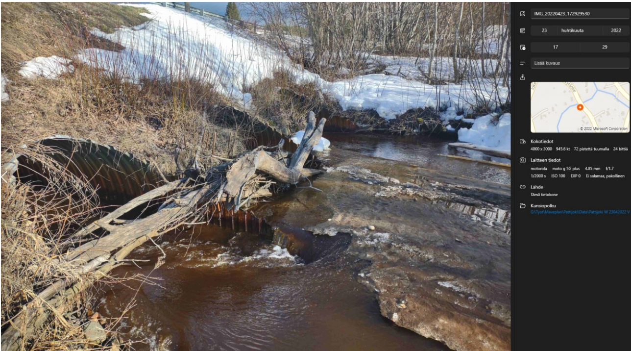
Kuva 15. Jokelankyläntiellä sijaitsevan kolmoisrummun tukkeutuminen on riski tulvatilanteessa. Kuva Markus Niemelä 23.4.2022.
