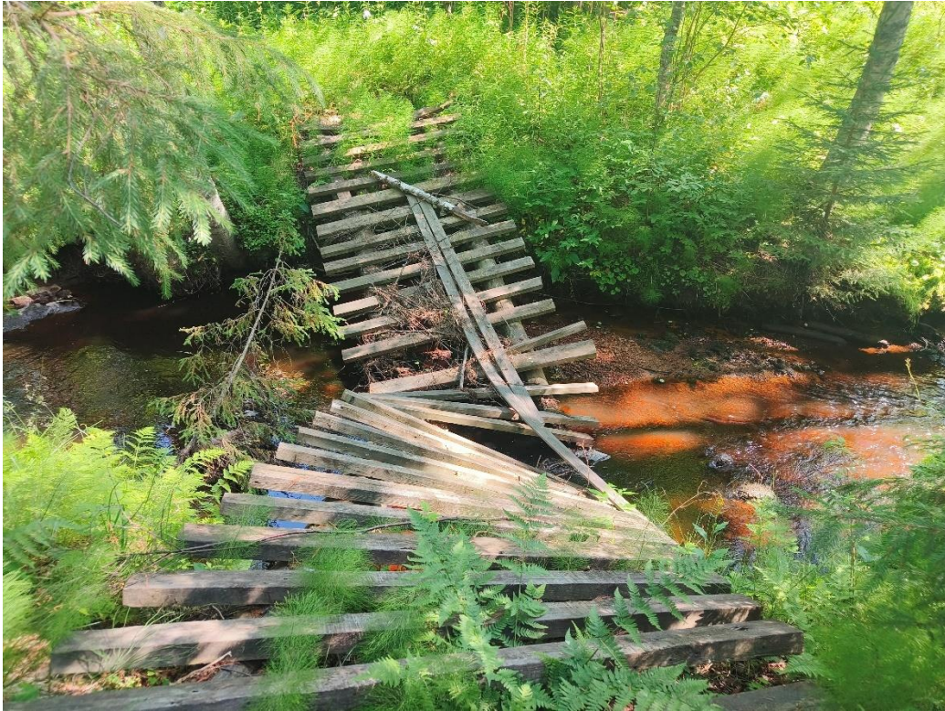
Kuva 13. Uomaan romahtanut puurakenteinen silta. Pitkä niva nro 25 kulkee sillan alla.
