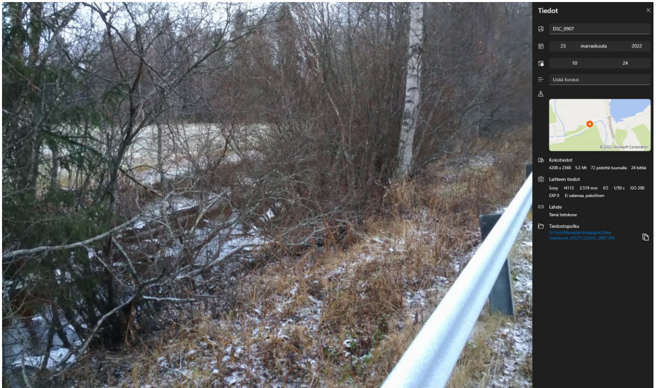
Kuva 5. Tien vierustassa menevä Haapajoen uoma on tukkoinen ja aiheuttaa padotusta merkittävälle alueella Haapajärven alapuolella. Kuva Pekka Leiviskä 23.11.2022.
