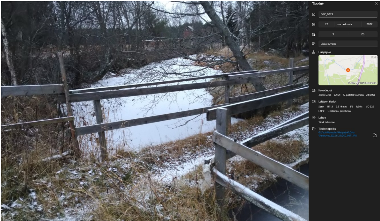
Kuva 28. Joitain puita kallistumassa jokiuomaan. Kuva Pekka Leiviskä 23.11.2022.
