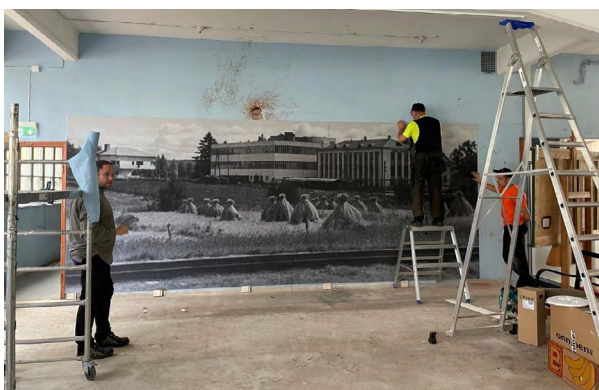
Kuva 71. Akustiikkalevyjä ei asennettu kattoon, vaan kuvasuurenoksella varustettuna peittämään huonokuntoinen seinäpinta.
