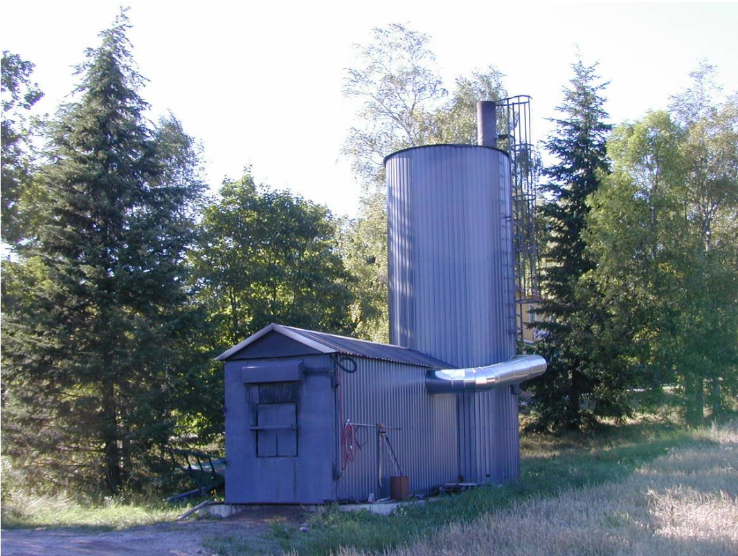
Kuva 8. Hagmanin tilan olkipaalikattila. Paalit työnnetään etukuormaajalla kattilan sisään avaamalla matalamman rakennuksen etuseinä. Vesivaraaja näkyy taaempänä korkeampana. Savupiippu on johdettu vesivaraajan läpi, jolloin osa hukkalämmöstä saadaan talteen. (Kuva: Timo Lötjönen, MTT)
