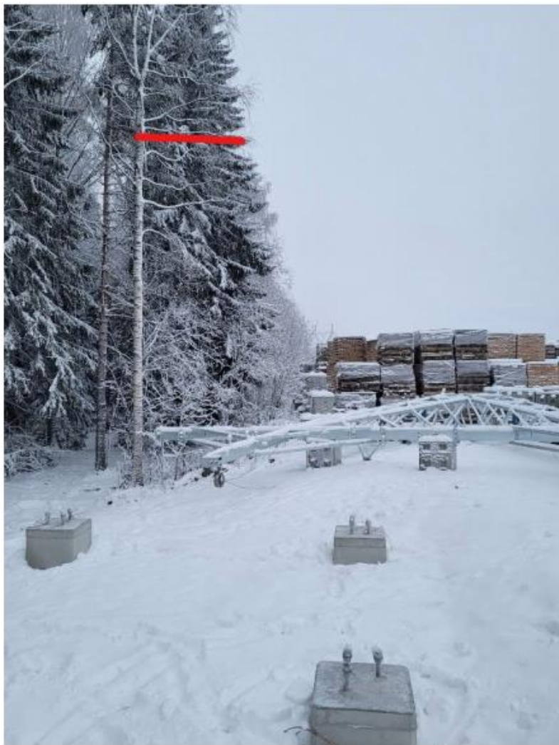
Kuva 2. Pituusrajoitus, kuvassa näkyy pystytetty pylväs takana.
