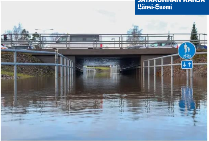
Prisman alikulku täyttyi vedellä Raumalla. KUVA: JUSSI HIETIKKO
