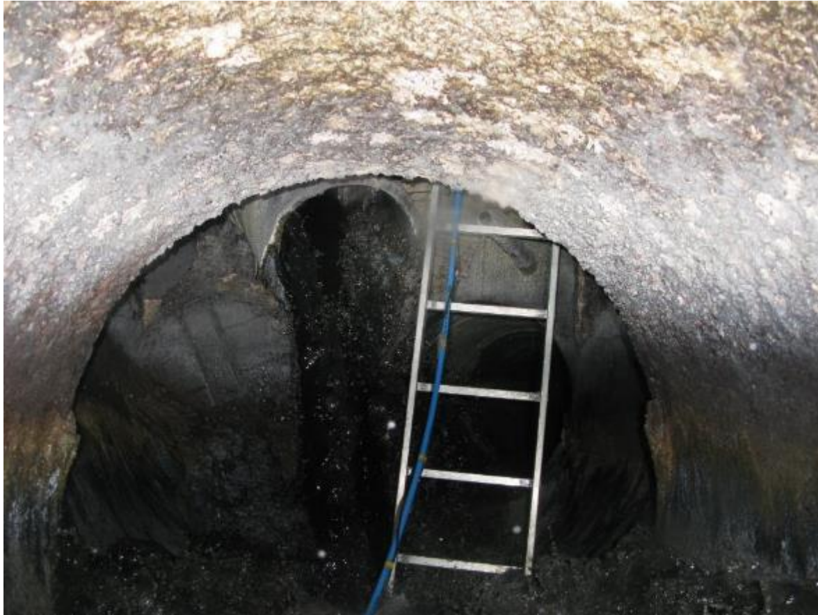
Jäteveden sisältämä rikkivety on vaurioittanut betoniputken pintaa.
