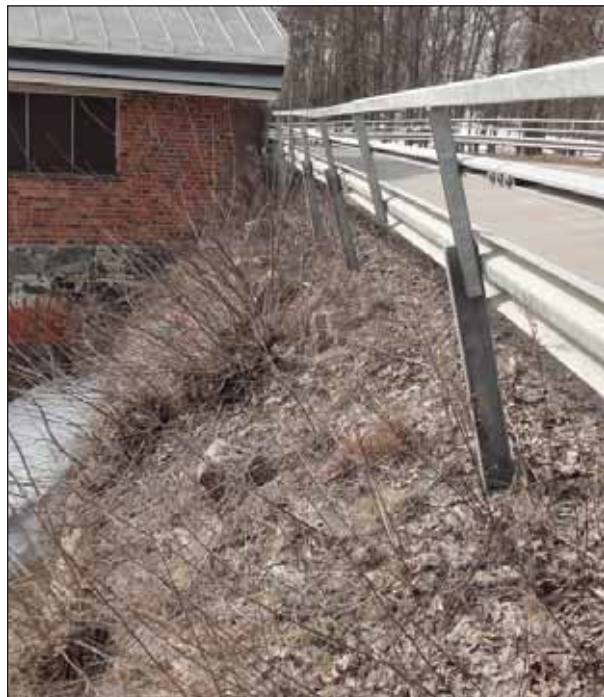
Qvarnbro ja myllyrakennuksen pengertä. Vanhat graniittiset kaidepilarit ovat jääneet heinän ja pensaiden sekaan ja yleisilme on epäsiisti. Kaide on vääntynyt ilmeisesti auraslumen painosta. Luiska kaipaa siistimistä. Kuva Laura Soosalu.
