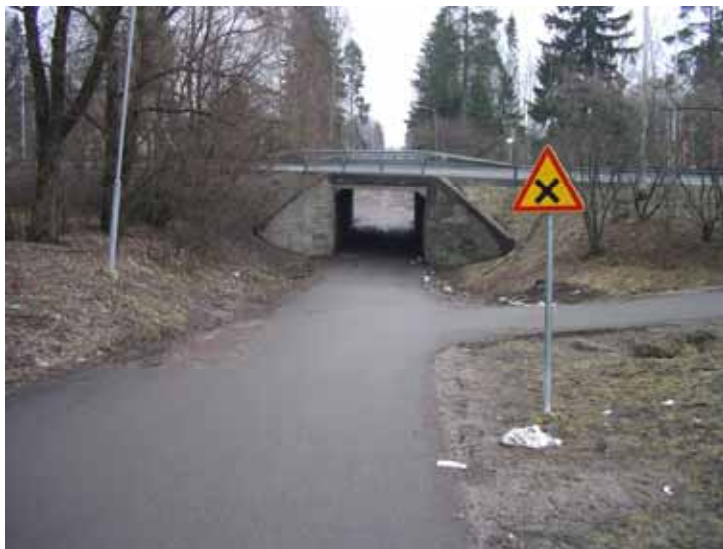
Kuva 29. Pohjoisväylän (mt 1456) alikulkukäytävät nousivat kyselyssä esille useaan otteeseen. Kaikista hankalimmaksi järvenpääläiset kokevat Muorinpolun alikulkukäytävän, jonka ongelmana on heikot näkemät.
