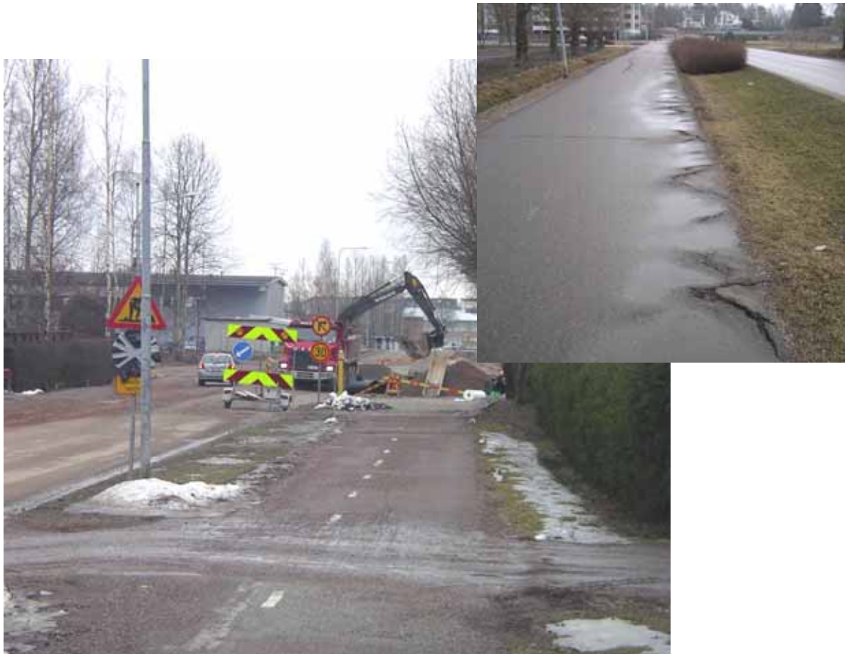
Kuva 38. Pietolankadulla (vas.) maastokäyntien aikaan käynnissä olleella tietyömaalla kevyen liikenteen opastus oli puutteellinen. Sipoontien varressa routa on paikoin saanut kevyen liikenteen väylän halkeilemaan (oik).
