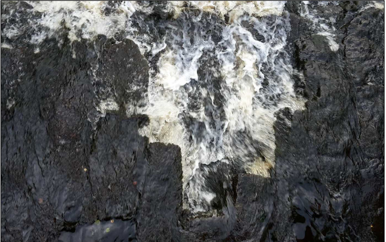
Kuva 4. Vasemman aukon kivipaasiin ladontaa ja purkautunut kohta.
